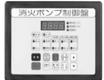
制御盤表示部
